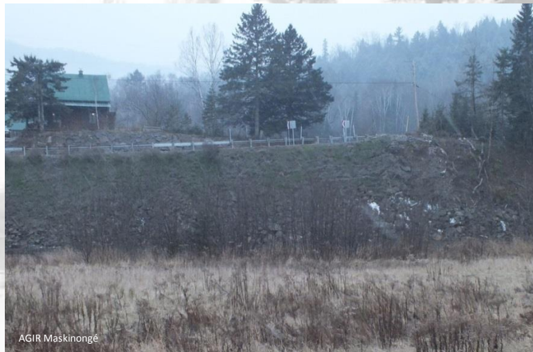
Figure 3.1.7 : Site du glissement de terrain de 2011-2012 le long de la rivière Mastigouche
