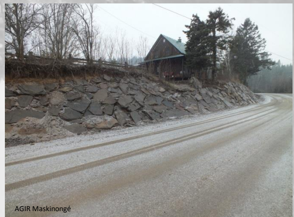
Figure 3.1.10 : La route a dû être abaissée de 2 mètres pour compenser l'effondrement du talus.
